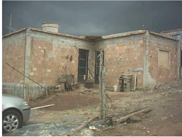
Fotografia 10 - Mostra as precárias condições do imóvel com duas portas para a entrada na residência, a falta de delimitação entre arruamento e terreno e ausência de acabamento externo – Fonte: (RICARDO, 2008).
