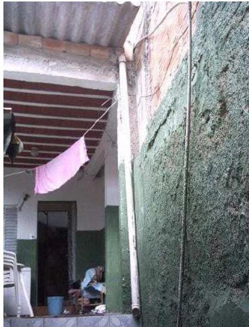
Fotografia 9 – Canos aparentes, beiral sem calha na entrada da casa e lajes de forro sem revestimento – Fonte: (RICARDO, 2008).
