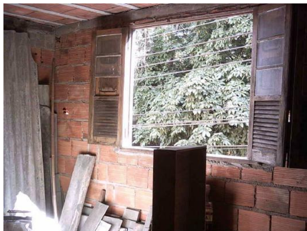
Fotografia 12 – Ambiente interno sem revestimento, laje da cobertura apoiada na verga da janela – Fonte: (RICARDO, 2008).
