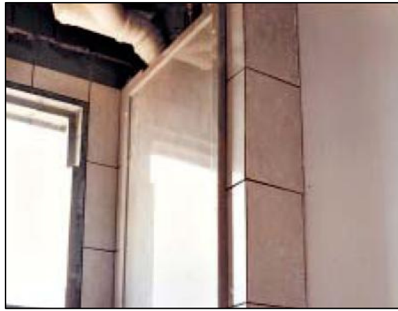
Fotografia 21 - Instalações em shafts - Fonte: (ABCP, 2002)
